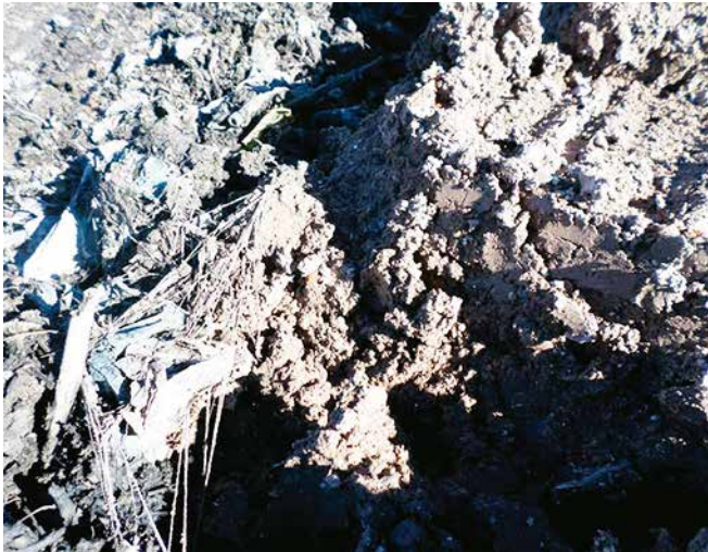
Estado de la subrasante. Detalle del relleno heterogéneo.
