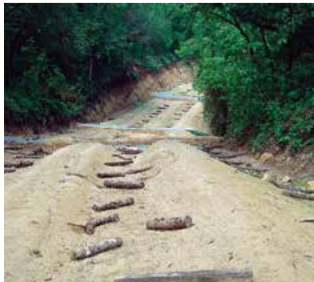
Protección de trazas de ductos
