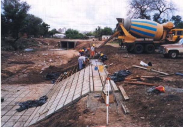
Foto 1: Hormigonado de un tramo de revestimiento desde la cresta del talud. Nótese la sencillez del encofrado utilizado y la inexistencia de equipo pesado.
