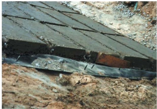
Foto 4: Detalles de los "pins" sintéticos ubicados en la zona de junta entre paños de geotextil.
