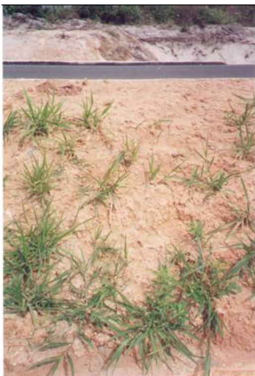
Notar a deficiência na pega na vegetação sobre o solo lançado, levando a processos erosivos.
