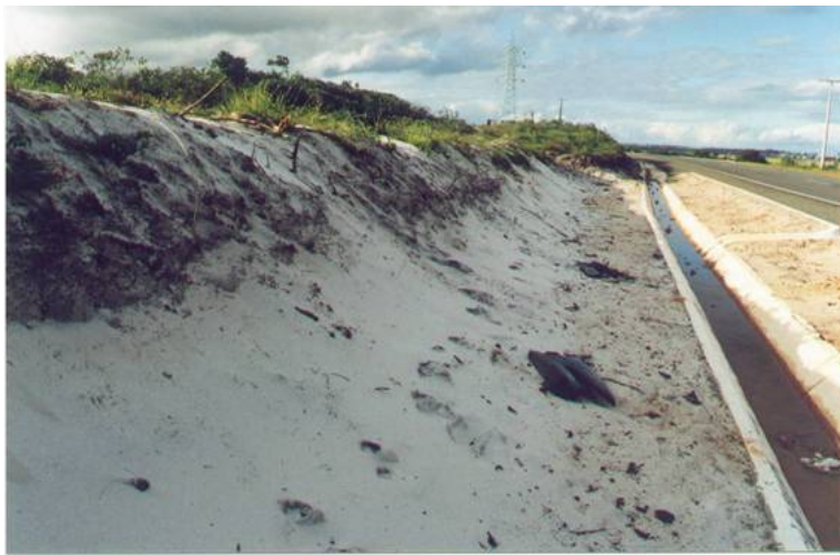
Aspecto do solo local, bastante arenoso e muito erodível.
