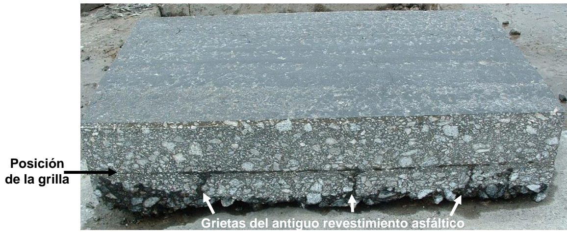
Figura 7 Detalles de la placa de concreto asfáltico de revestimiento en estado de grietas
